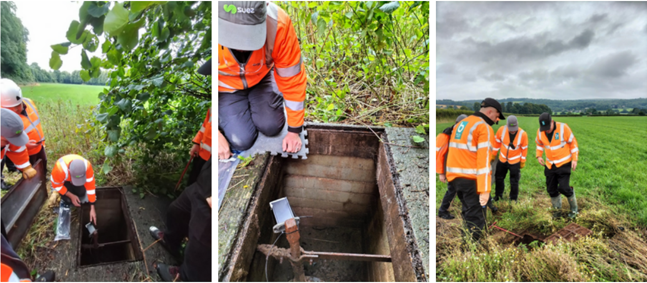
Instalación de sincronizadores a lo largo de la tubería para garantizar una localización precisa de los incidentes.
