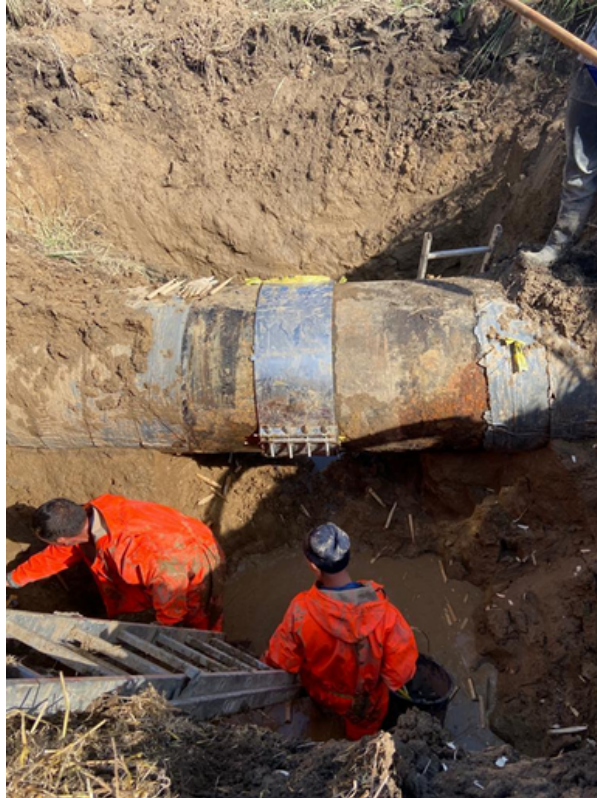
Excavación que confirma una de las fugas importantes detectadas
