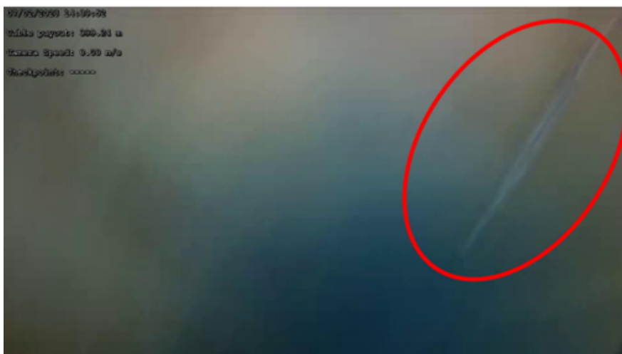
Grieta longitudinal con fuga
